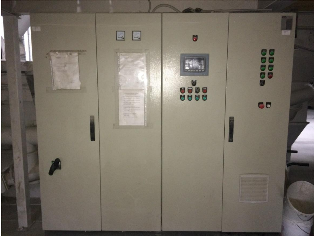
Slika 3.4. Glavni ormar upravljanja linijom pripreme materijala
