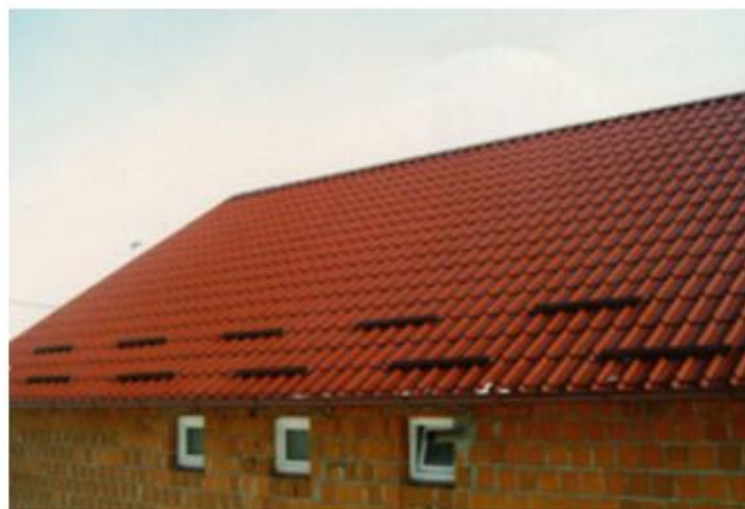
Slika 3.11. Elementi građevinske limarije (oluk, krovni pokrov, snjegobran) na obiteljskoj kući
