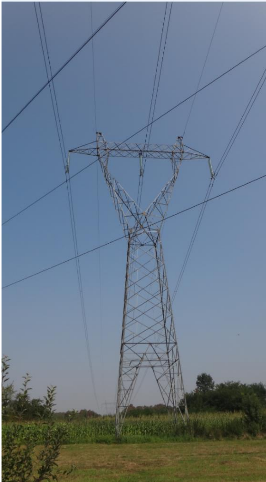
Slika 3.16. Prikaz 220-kV trofaznog dalekovoda Đakovo-Tuzla
