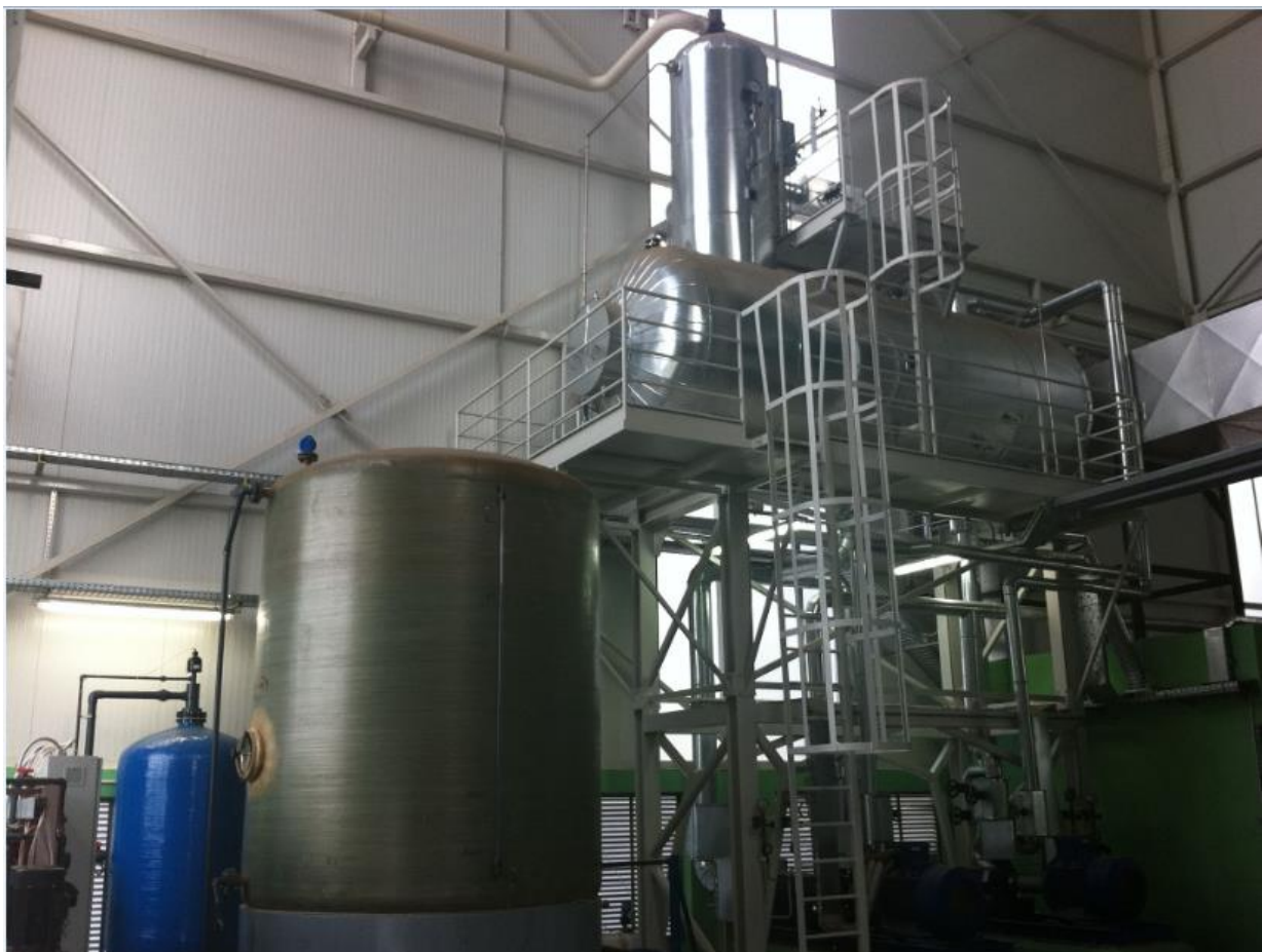
Slika 5.10. Termička priprema vode
