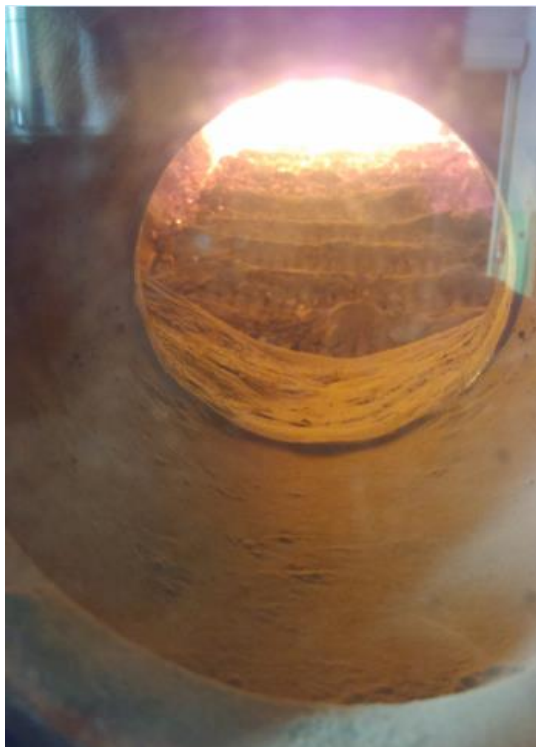
Slika 5.6. Unutrašnji dio kotla
