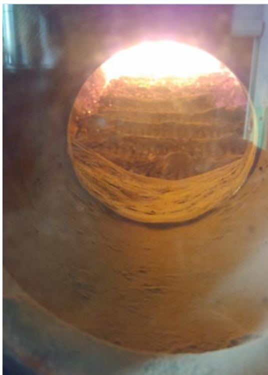
Slika 5.6. Unutrašnji dio kotla
