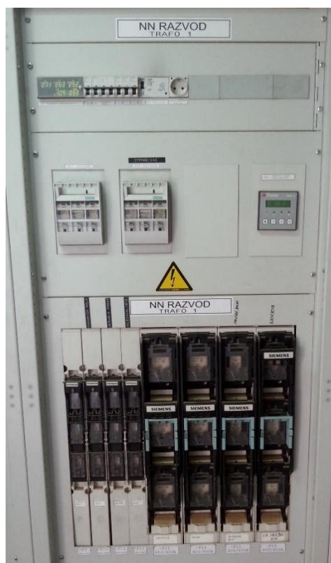
Slika 5.8. Niskonaponski razvod transformator 1
