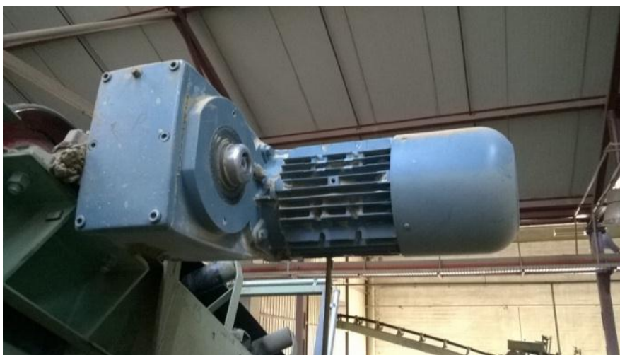
Slika 4.7. Transportna traka i asinkroni motor
