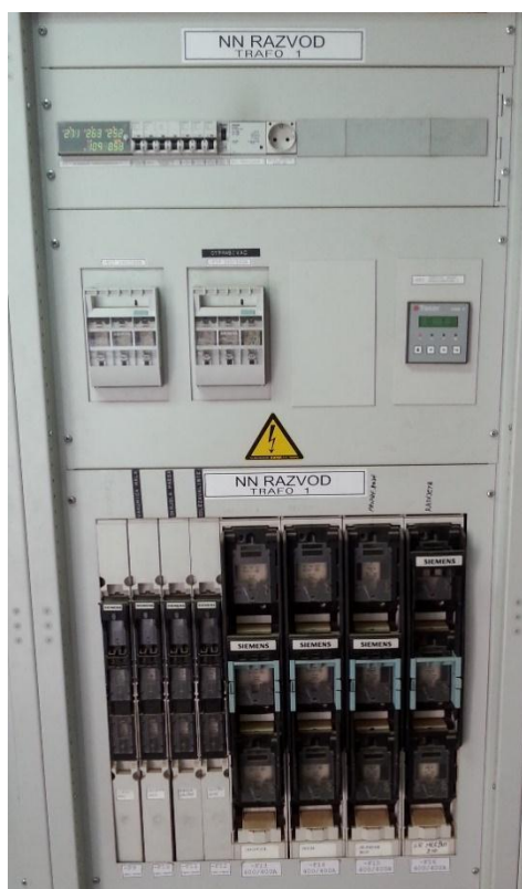
Slika 5.8. Niskonaponski razvod transformator 1
