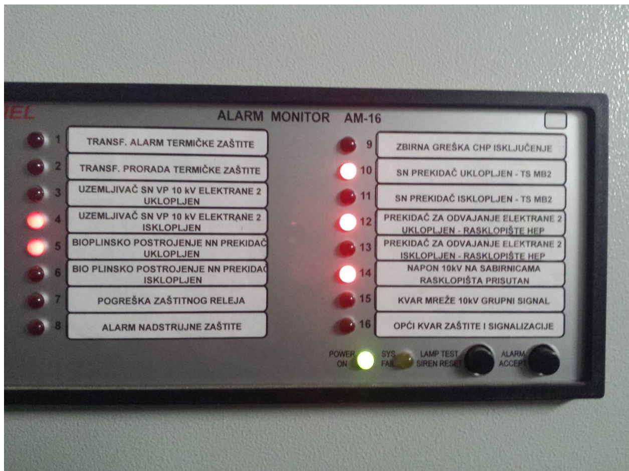
Slika 5.22. Alarm monitor u transformatorskoj stanici [fotografirano 8. lipnja 2015.]
