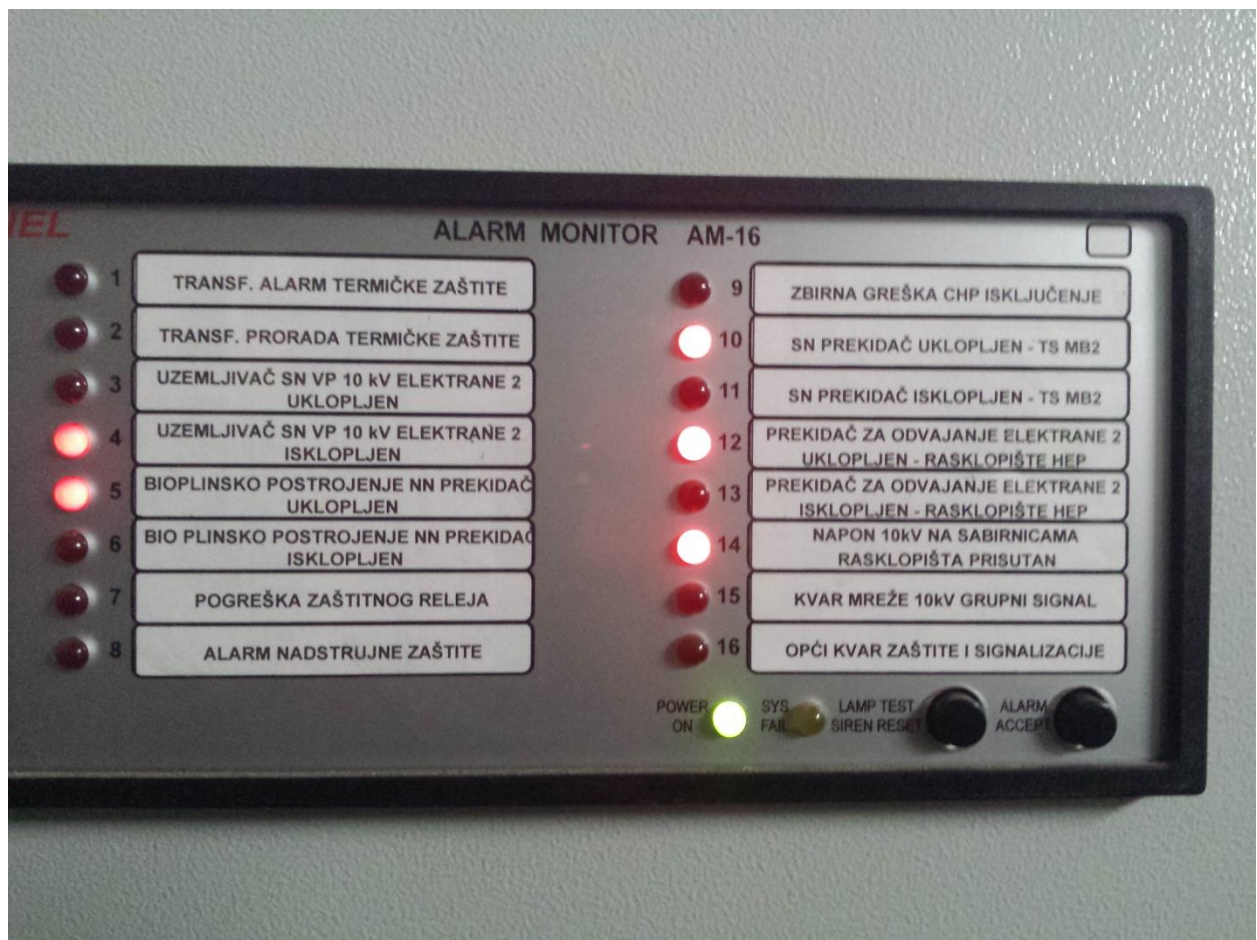
Slika 5.22. Alarm monitor u transformatorskoj stanici [fotografirano 8. lipnja 2015.]
