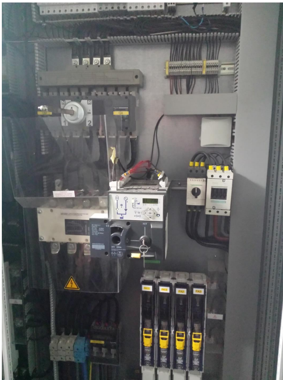
Slika 5.20. Unutrašnjost transformatorske stanice [fotografirano 1. prosinca 2014.]
