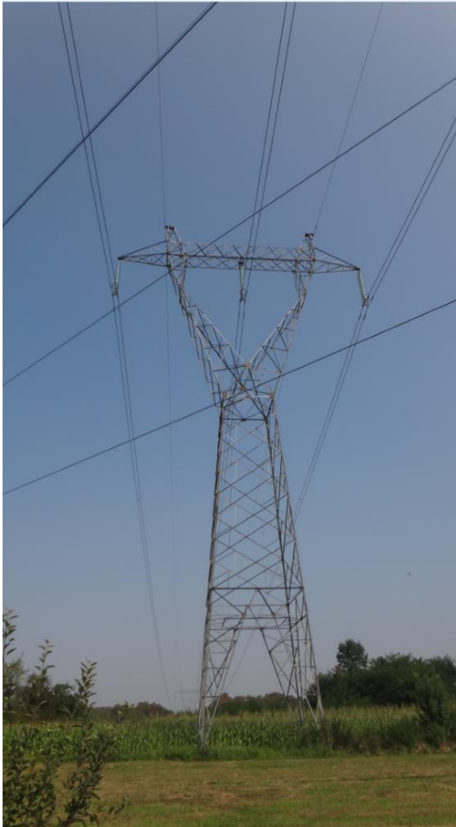
Slika 5.5. 220kV trofaznoi nadzemni vod na relaciji Đakovo-Tuzla, [13].
