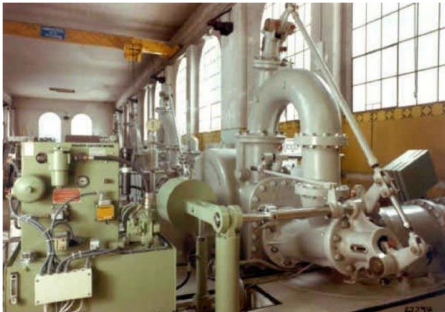
Sl. 4.1. Modernizirani sustav upravljanja (1986.) u Burglauenen (Jungfrauoch-Bahn, Švicarska), sa dvije Peltonove jedinice po 1 MW. [9]
