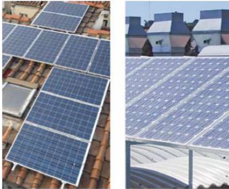
Slika 3.18. Primjeri fotonaponskih sustava spojenih na mrežu. [8]
