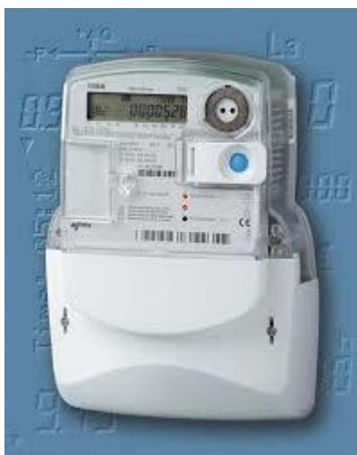
Slika 2.3. Trofazno više funkcijsko brojilo djelatne, a na zahtjev i jalove energije, s ugrađenim GSM-GPRS-modemom ili sučeljem RS485
