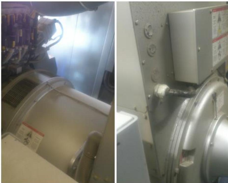
Slika 1. Stamford sinkroni generator[2]
