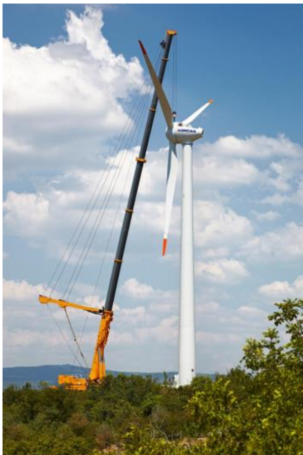
Slika 4.8: Toranj vjetroelektrane K80 2.5 MW
