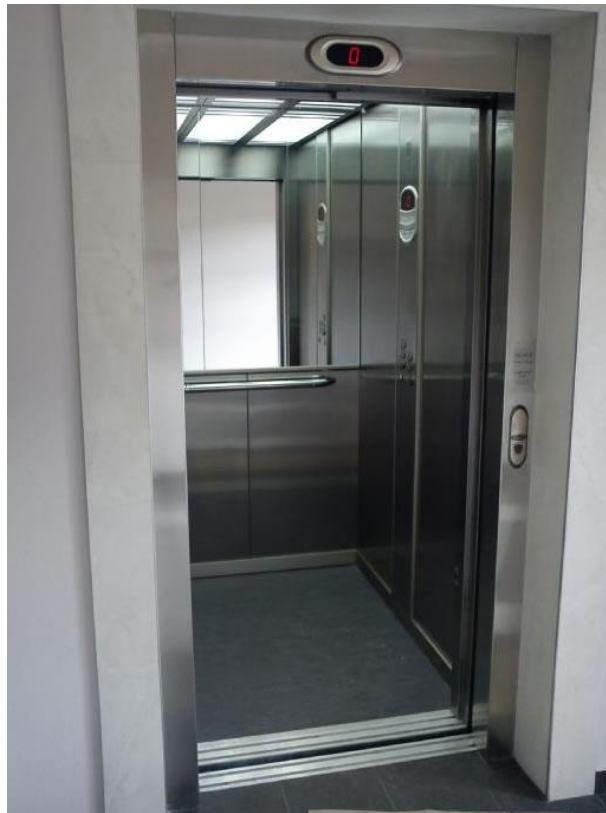
Slika 3.4. Primjer unutrašnjosti etažnog dizala [4].
