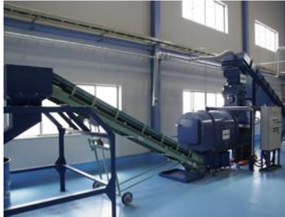
Slika 4.11. Jedinica postrojenja za odvajanje metala, plastike i stakla
