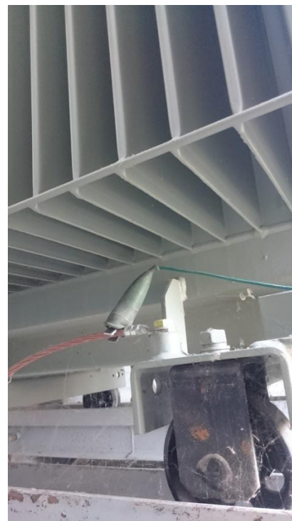
Slika 4.14. Spoj vodiča s instalacijom za uzemljenje transformatora
