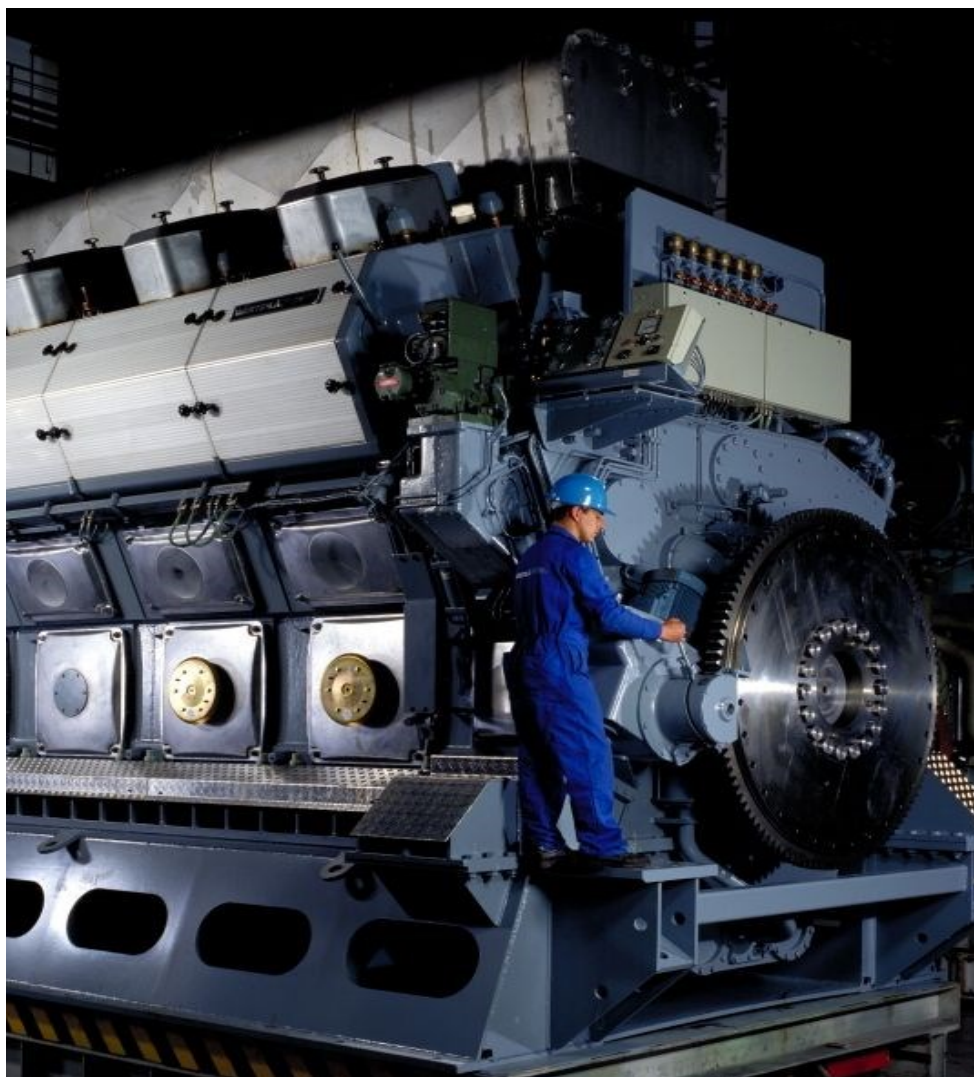
Slika 5.3.4. Dizel generator Wartsila 16V46C strana vratila
