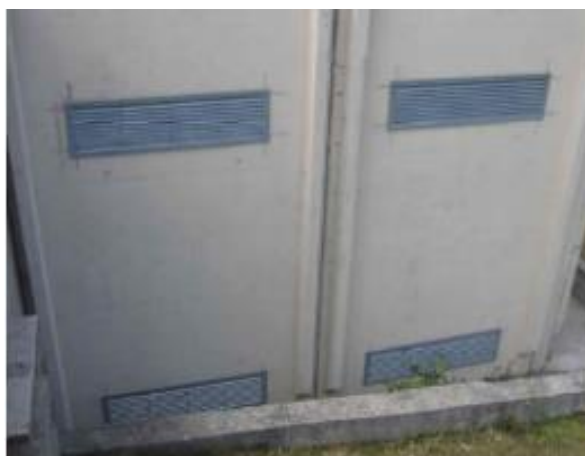
Sl. 2.8. Primjer prirodne ventilacije. [1]
