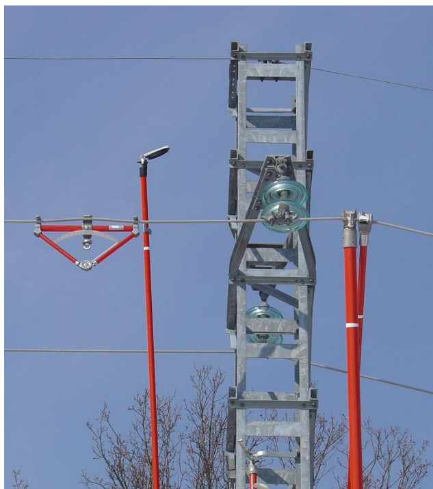
Sl. 4.2. Vizualni pregled vodiča uz pomoć ogledala na kraju izolacijskoj cijevi i praćenje mehaničkog naprezanja vodiča dinamometrom [7]
