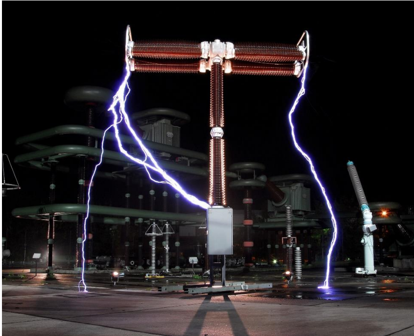
Slika 3.1. Prenaponsko ispitivanje 550 kV-nog VN prekidača
