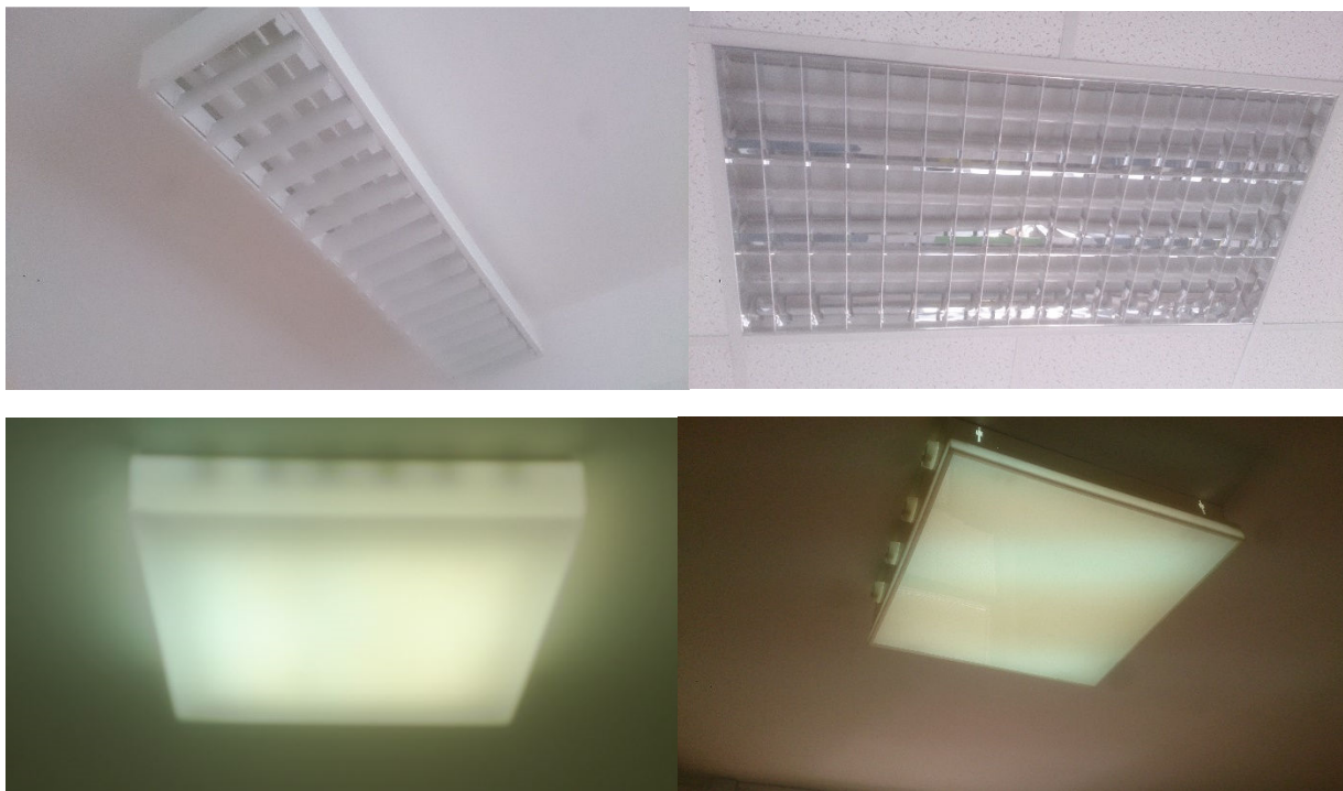
Slika 3.1. Postojeća rasvjeta objekta
