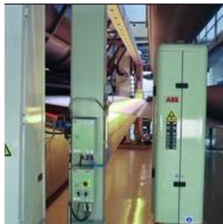
Slika 3.4. Prikaz mjerne platforme
