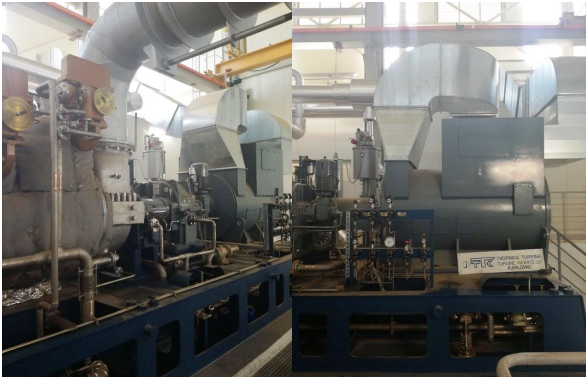
Sl. 2.3. Prikaz turbine postrojenja (slikano 14.08.2017.).
