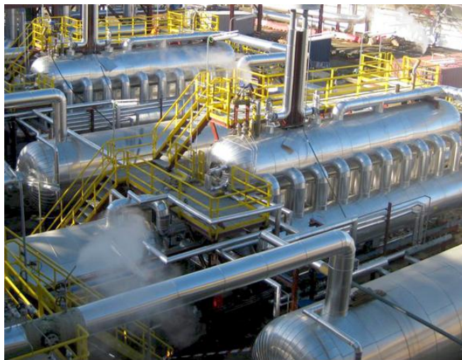
Sl.2.7. Generator pare [7].
