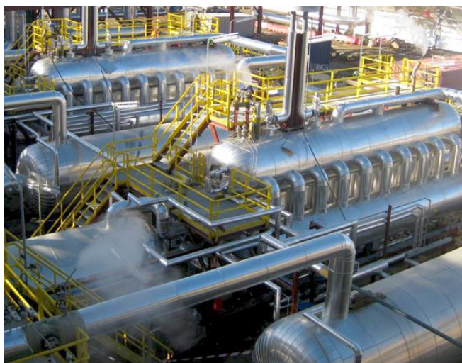
Sl.2.7. Generator pare [7].
