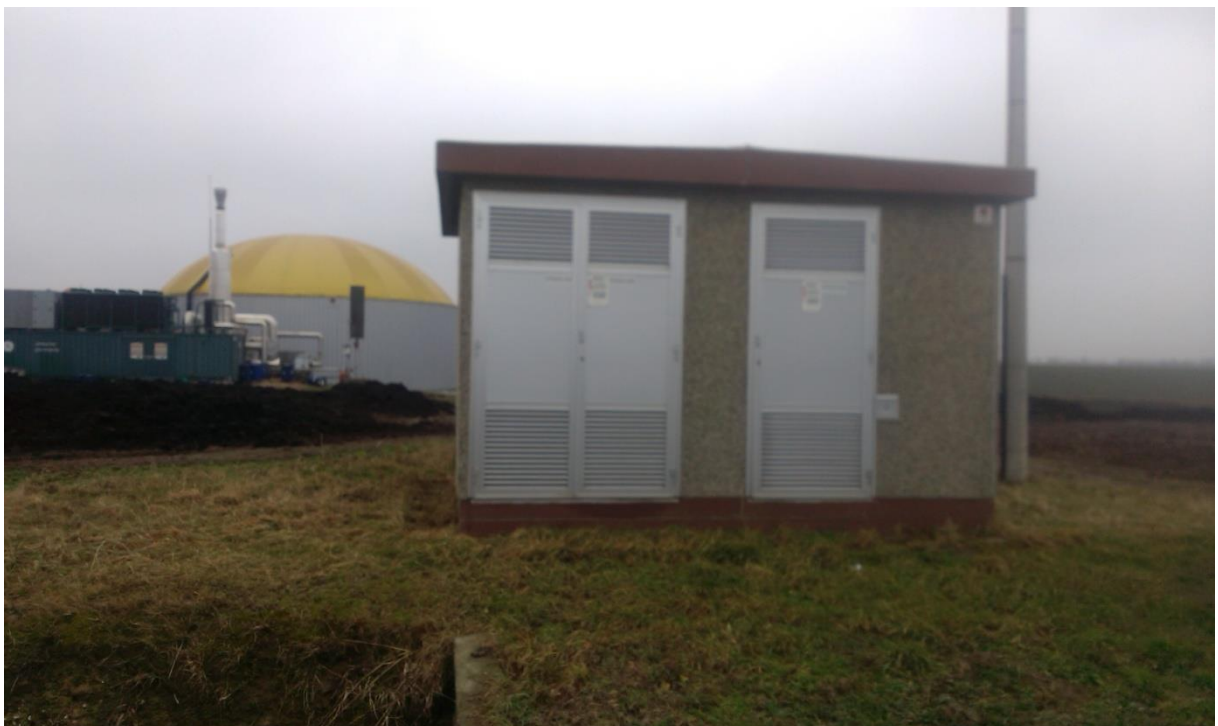
Slika 5.23. Transformatorska stanica HEP-a
