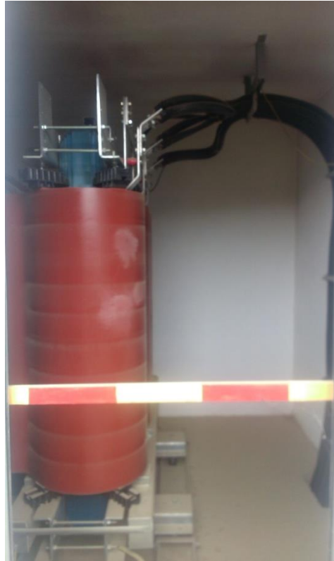
Slika 5.22. Unutrašnjost transformatorske stanice
