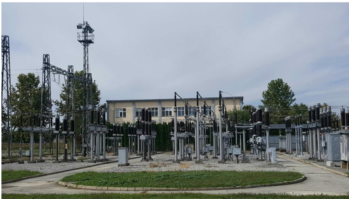
Slika 3.1. Transformatorska stanica (mjerni transformatori) - Osijek, 2017.
