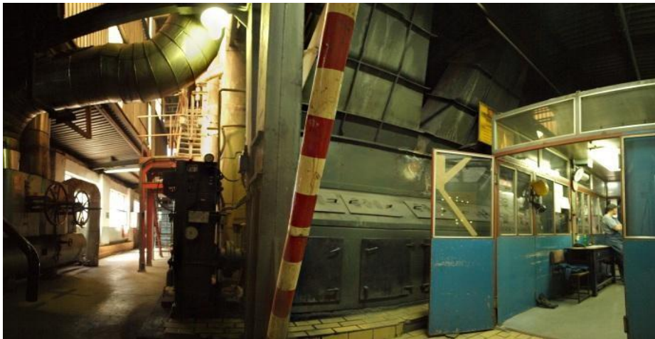
Slika 5.2. Kotao 5568 upravljačka soba
