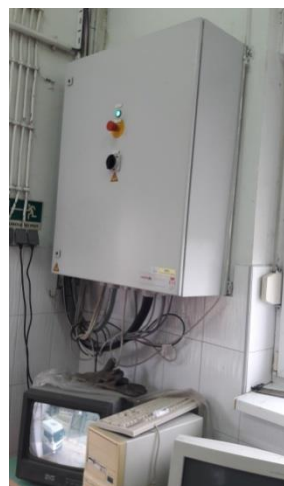
Slika 4.3 Razvodni ormar za sondu
