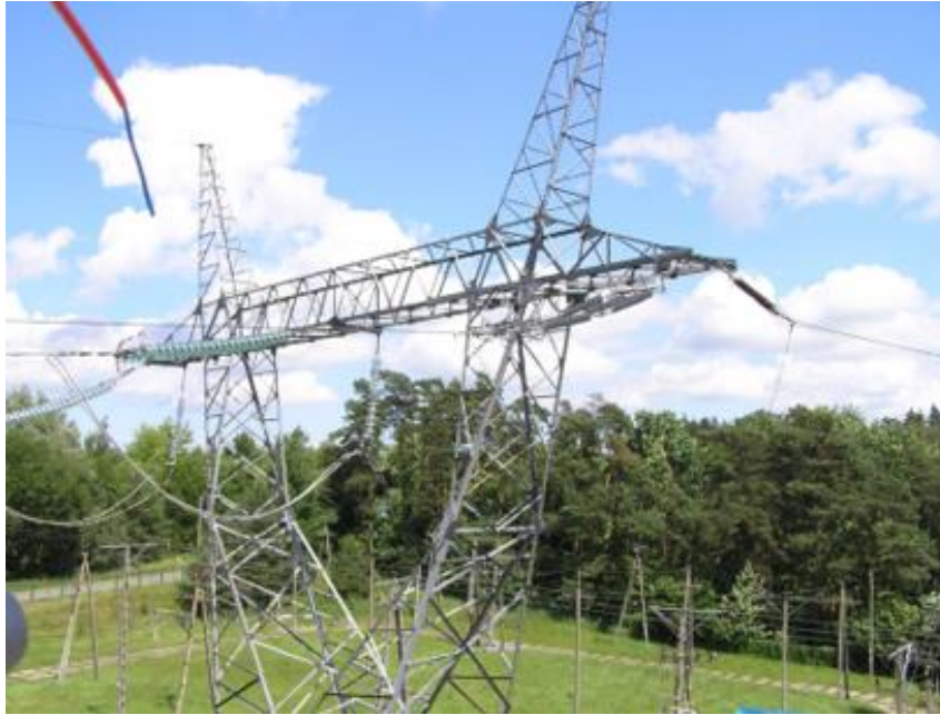
Sl. 3.14. Pogled na 400 kV poligon [10].
