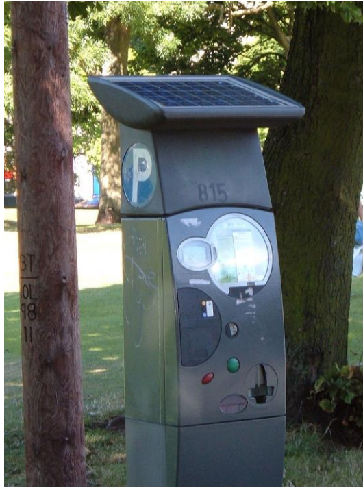
Slika 3.5. Primjena samostalnog FN sustava za sustav parkiranja [11]
