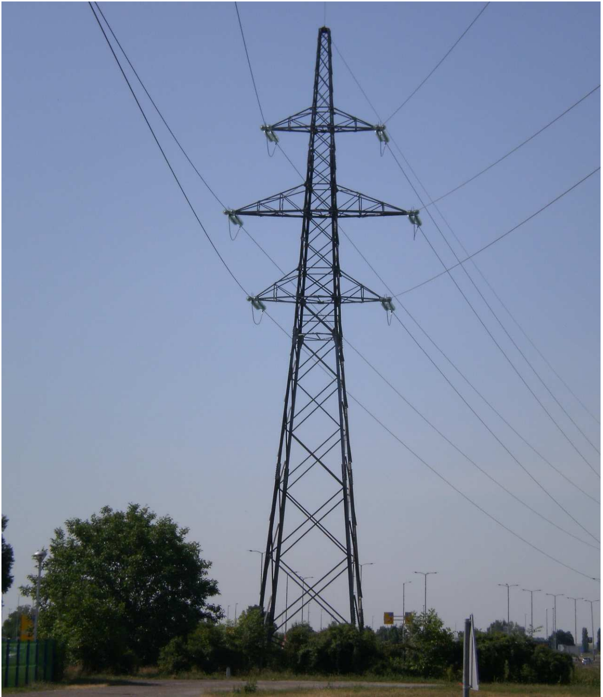
Sl. 2.14. Dvostruki čelično-rešetkasti stup 110 kV
