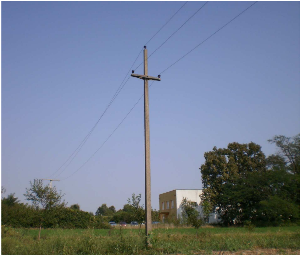
Sl. 2.16. Betonski stup 10 kV
