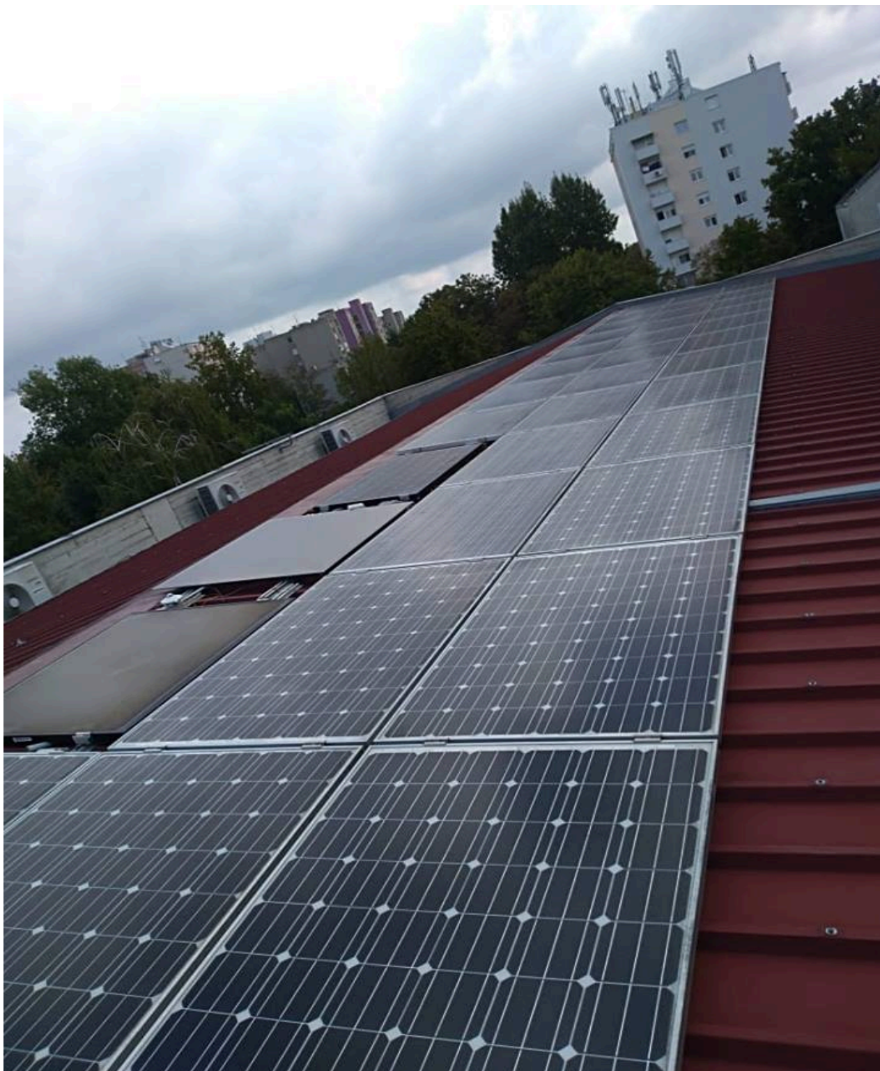
Slika 3.3. Fotonaponska elektrana FERIT-a
