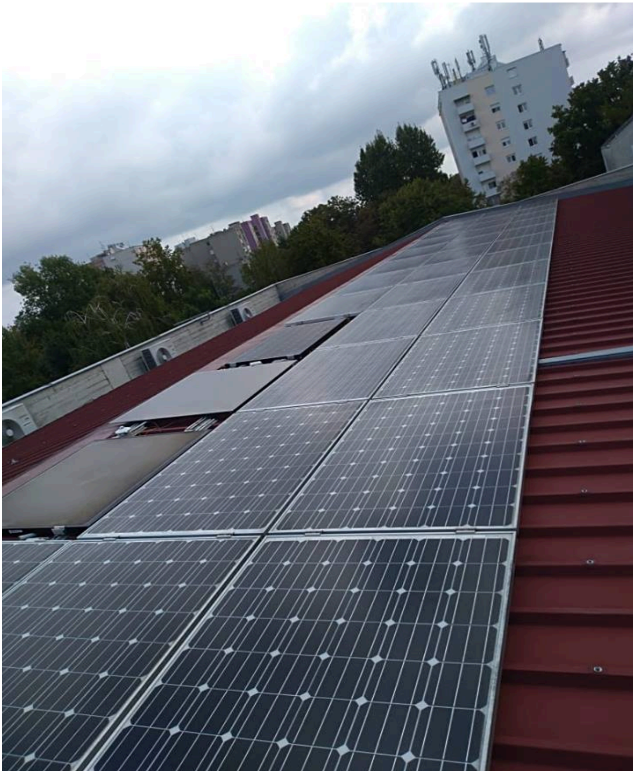
Slika 3.3. Fotonaponska elektrana FERIT-a
