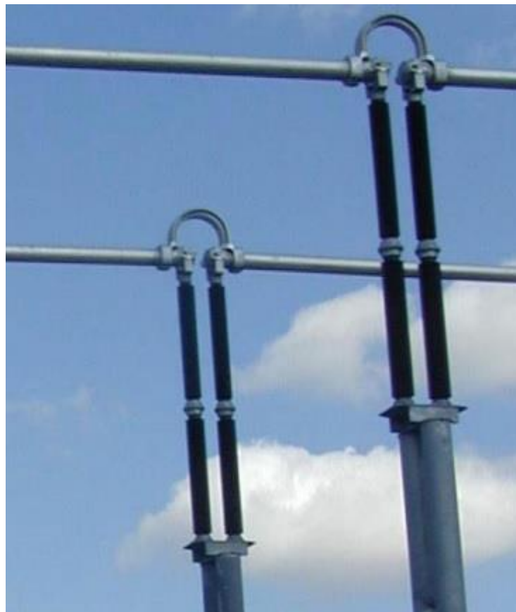
Slika 3.2. Potporni izolator na 400 kV-noj sabirnici [4]
