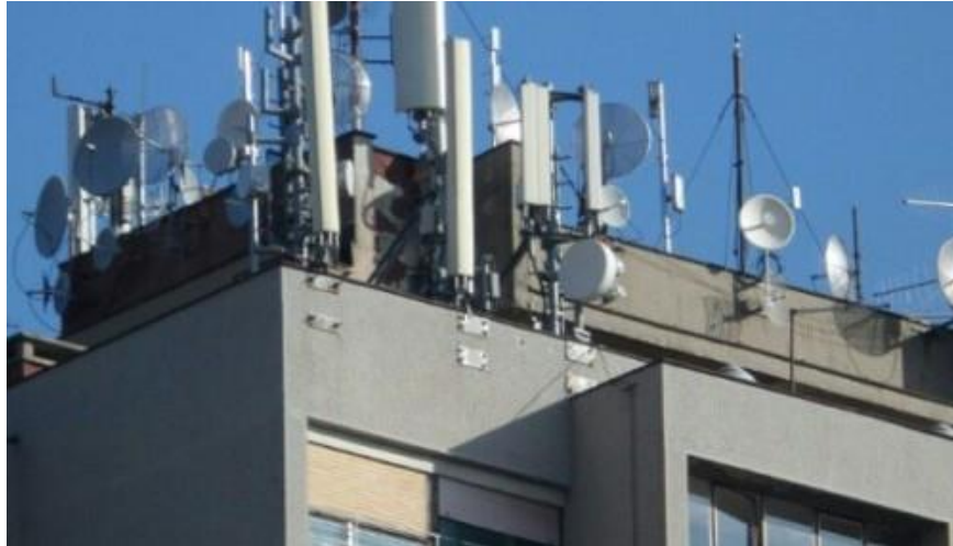
Sl. 3.1. Antenski sustav na krovu zgrade
