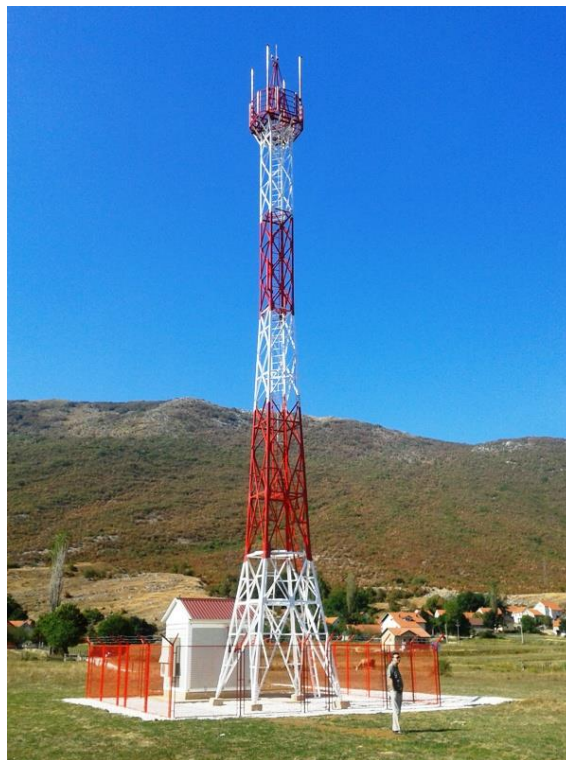
Sl. 3.2. Bazna postaja montirana na samostojeći stup
