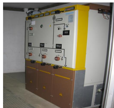
Sl.3.4.Daljinski upravljivi VDA blok
