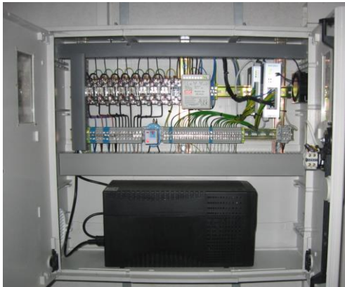
Sl.3.3.Razvodni ormar za daljinsko upravljanje TS-om
