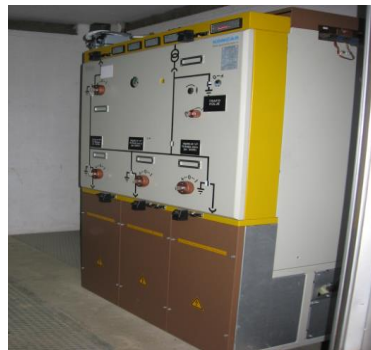
Sl.3.4.Daljinski upravljivi VDA blok
