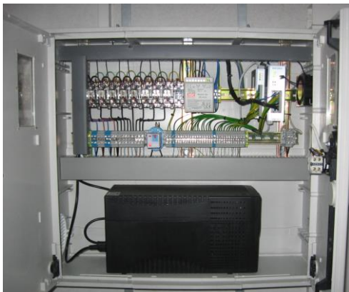
Sl.3.3.Razvodni ormar za daljinsko upravljanje TS-om
