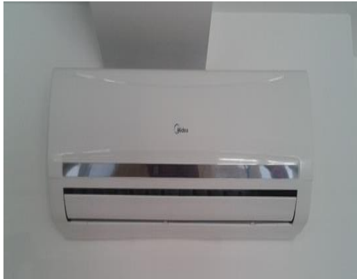
Slika 6.3. Prikazuje klima uređaj tipa „Midea“ korištene za hlađenje tijekom ljetnih mjeseci na obiteljskoj kući.
