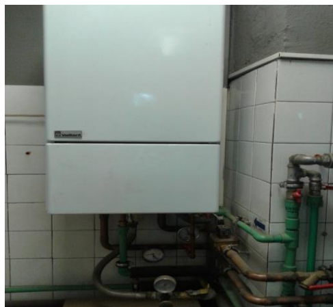
Slika 6.2. Prikazuje plinski kombi bojler koji je korišten za grijanje i potrošnu toplu vodu na obiteljskoj kući.
