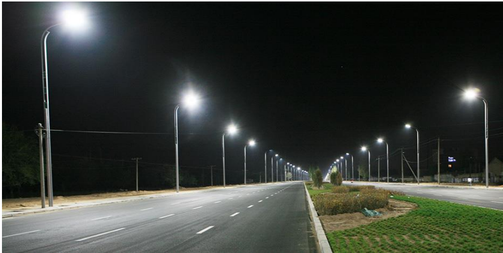
Slika 2.1. Javna rasvjeta prometnice [1]
