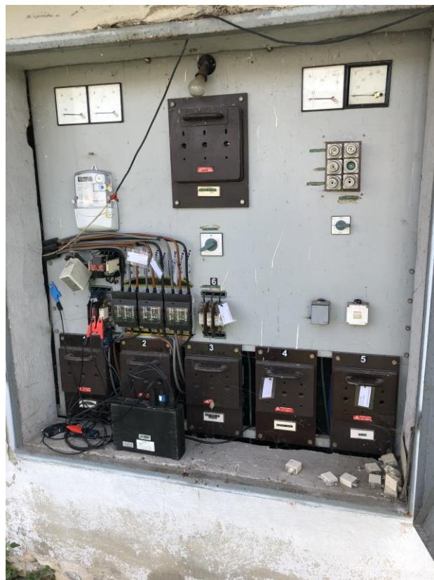
Slika 4.16. Zidna trafostanica PTTS 568
