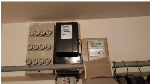
Slika 4.43. Karakteristični razdjelni ormar karakterističnog stambenog prostora.
