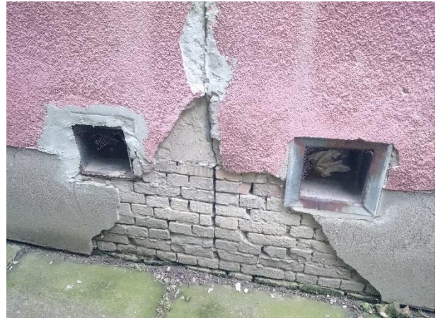
Slika 4.22. Oštećenja na cokol zidu podruma.
