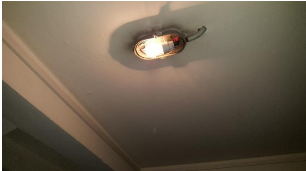
Slika 4.41. Rasvjeta zajedničkog komunikacijskog prostora (stubište).
