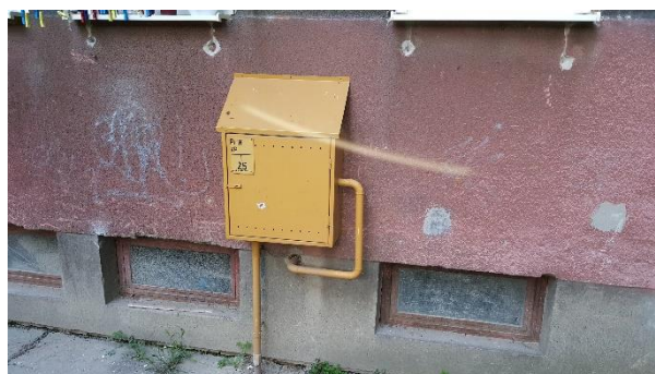
Slika 4.38. Glavni plinski priključni mjerni ormarić zgrade (MRS).
