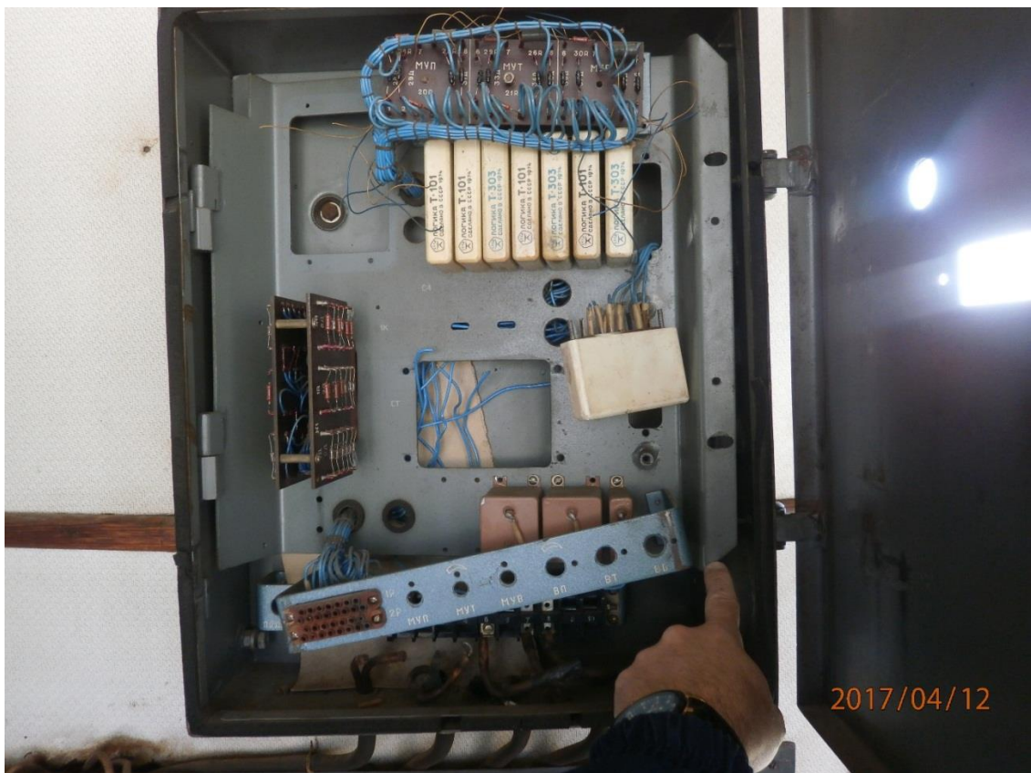
Slika 2.2. Izgled unutrašnjosti upravljačkog ormara u upravljačkoj kabini
