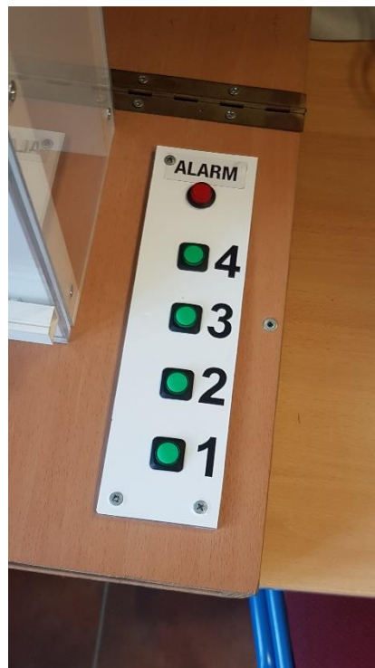
Slika 3.14. Upravljačka ploča makete dizala
