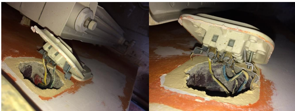
Sl. 5.3.3.1. Fotodokumentacija žica spojenih na prekidaču
