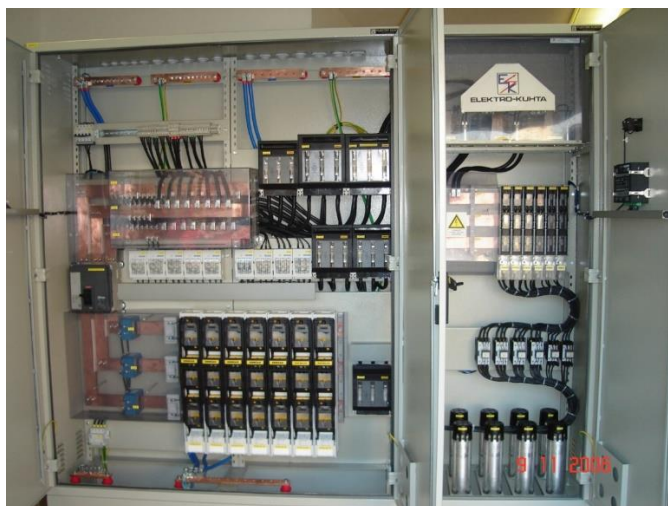
Sl. 5.1.1. Unutrašnjost razvodnog ormara
