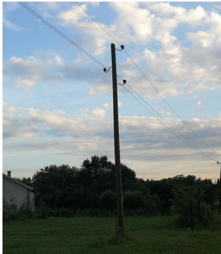
Slika 4.12. 10(20) kV linijski drveni stup
