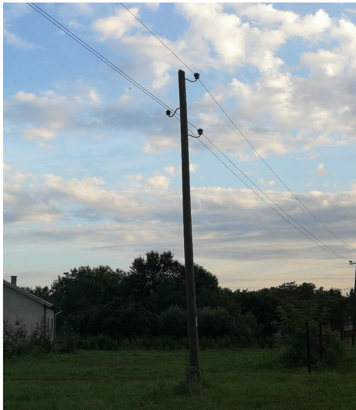
Slika 4.12. 10(20) kV linijski drveni stup
