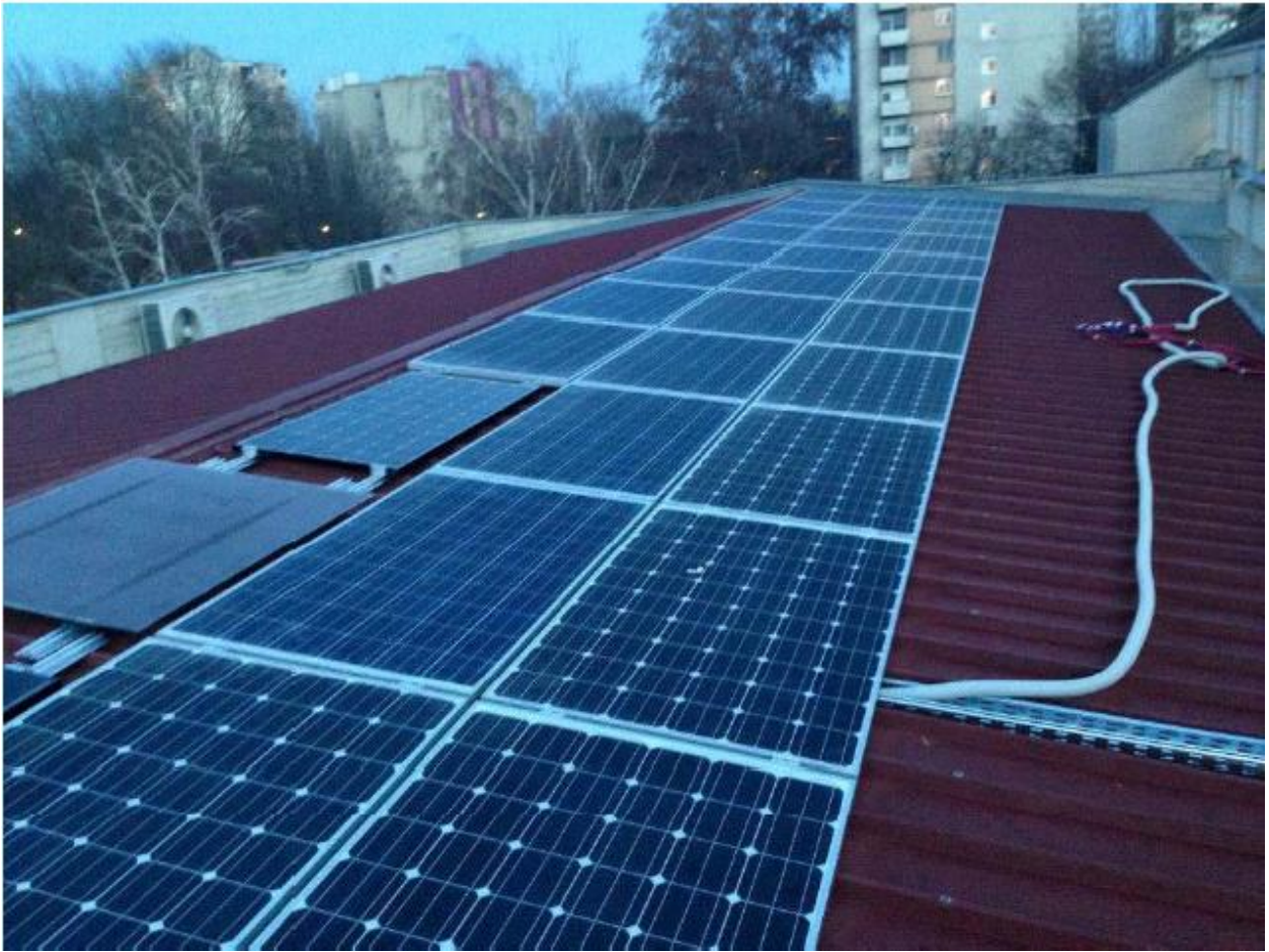
Slika 4.1. Fotonaponski moduli na krovu FERIT-a
