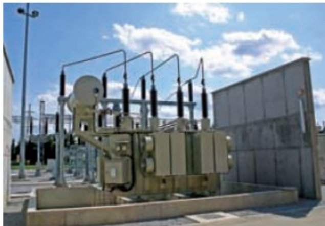
Slika 54. Transformator od 20 MVA u trafostanici 110/10(20) kV Osijek 4
