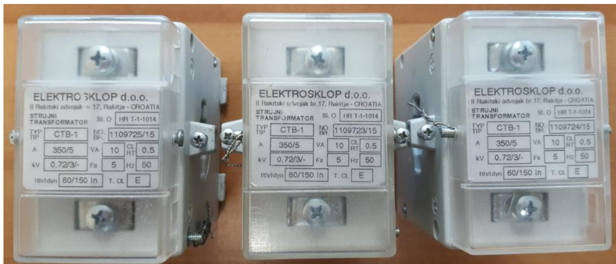
Slika 6.4 Strujni mjerni transformator
