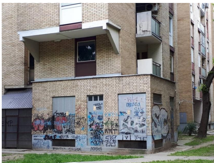
Slika 2.6. Distributivna trafostanica ugrađena u zgradu
