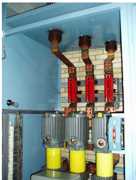
Slika 7.5. TP 10 kV br. 1
