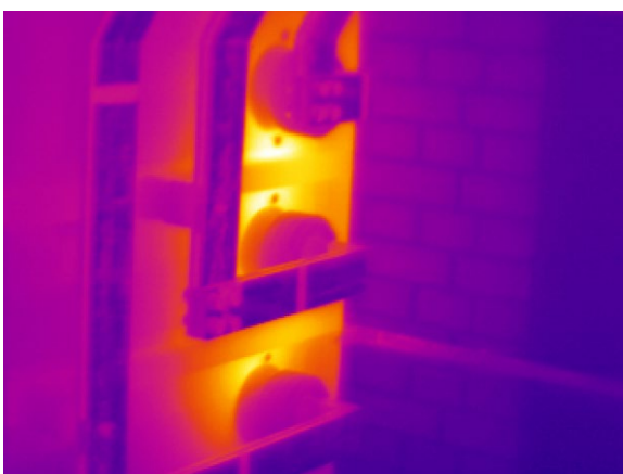
Slika 7.9. IR slika prolaza sabirnica između MSP i SP 10 kV
