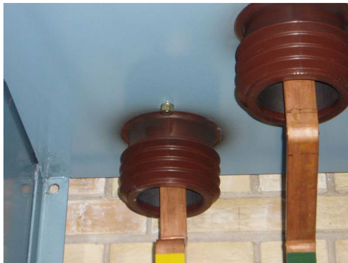
Slika 7.13. Vidljive promjene u boji limova uz prolazne izolatore na provodnim pločama
