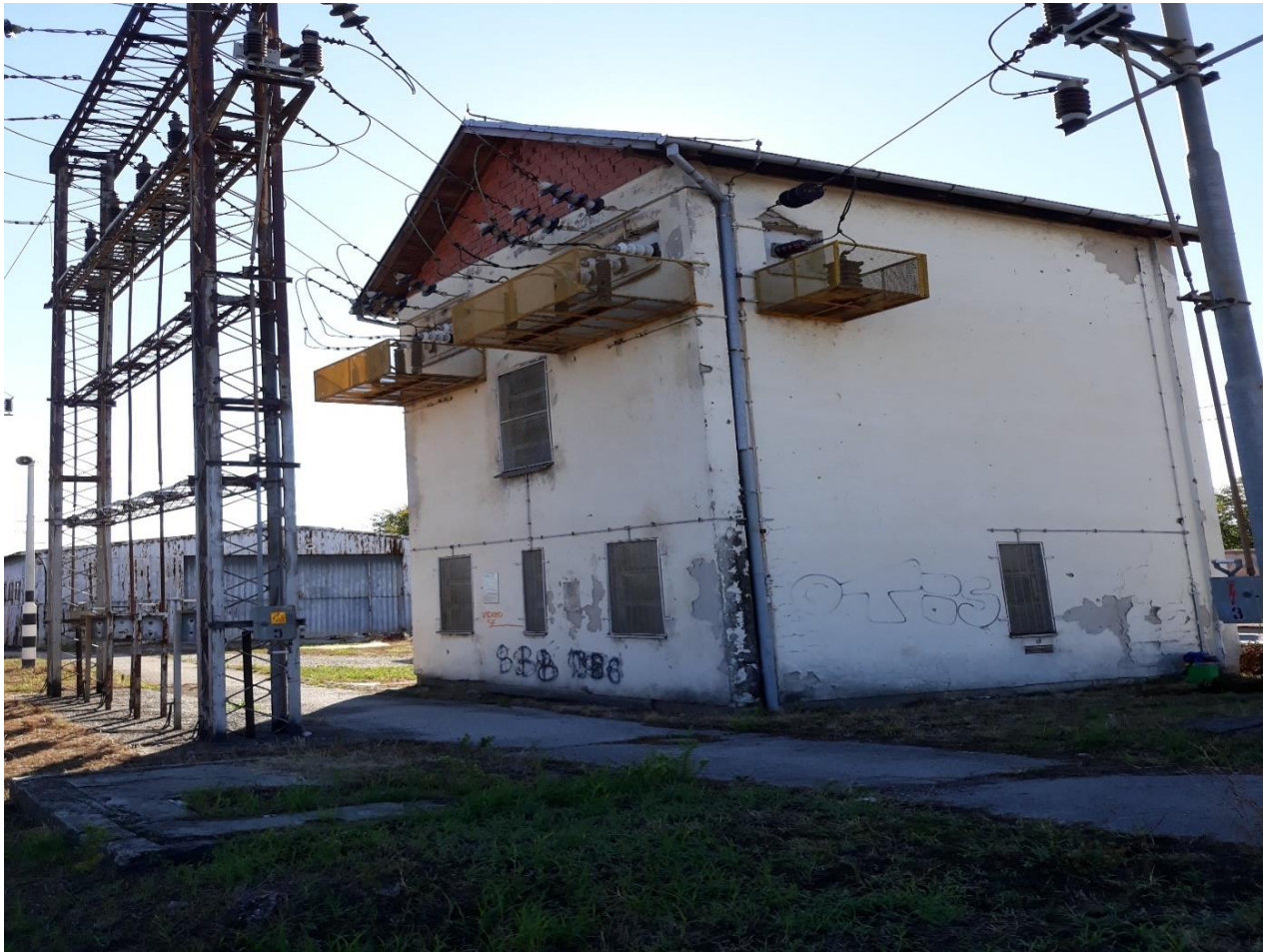
Slika 3.2 Stvarni izgled elektrovučne podstanice[6]
