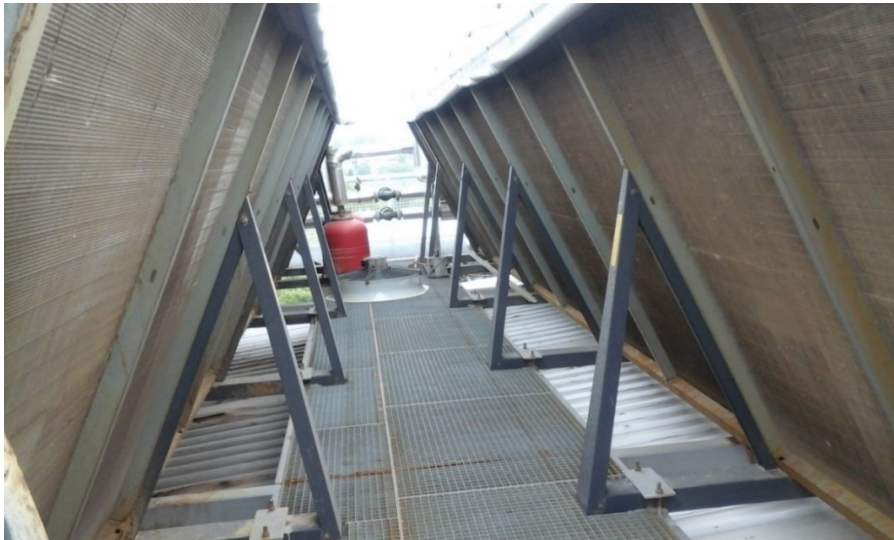
Slika 3.21. Hladnjaci na krovu postrojenja
