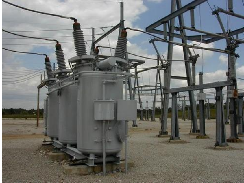
Sl.2.10 Transformatorski prekidač
