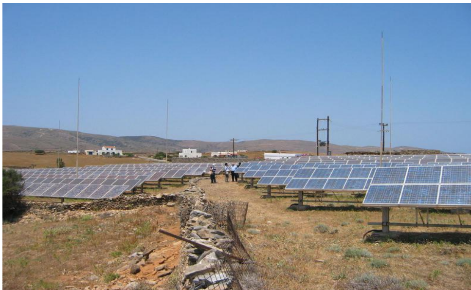
Slika 4.2. Prikaz fotonaponskih panela na otoku Kythnos [18]
